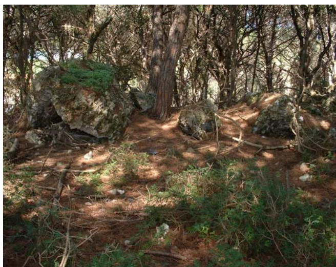
Fig. 9. Tombolo di Feniglia. Crollo di volte in calcestruzzo.
